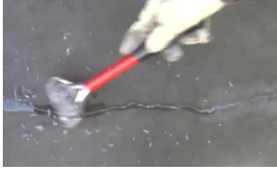
شكل (8) يتم حك سطح الخرسانة بعد أن تجف المادة و تتماسك مع الخرسانة و تصبح كأنها جزء منها ، ثم بتنظيف السطح و مساواته تماما .المصدر:12
