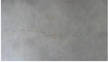
شكل (1) يوضح الشروخ الأفقية التي وجدت في ارضية سقف الدور الارضي بالمبنى. المصدر: 12
