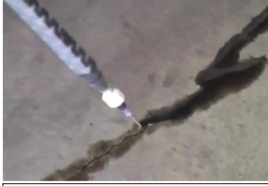
شكل (4) يوضح حقن الشروخ الخرسانية بمادة Spall TX أكثر من مرة للشروخ الواحد. المصدر : 12
