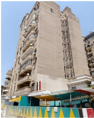
شكل ٩: حدوث ميل بعمارة الشريتلي بسبب أعمال حفر مترو الأنفاق مما أدى إلى هبوط أرضي للتربة المصدر:
