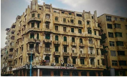
شكل ٨: يوضح تآكل قشرة البياض بإحدى العمارة السكنية التي تطل على البحر بالإسكندرية المصدر:
