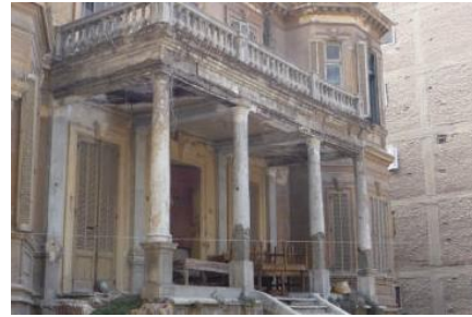
شكل ٦: تآكل في البياض والأعمدة بسبب الأمطار [ https://www.almonitor.com/pulse/originals/2018/03/egyptian-campaign-tries-to-protect-architecture.html ] (Accessed: 1/5/2016 at 2:50 PM)
