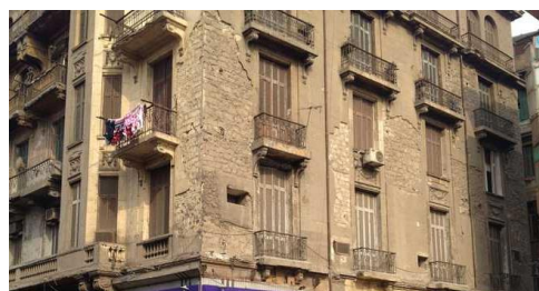
شكل ٣: يوضح تفتت الطبقات السطحية للطوب نتيجة لتفاوت درجة الحرارة
