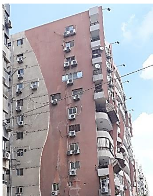
شكل ٢: بهتان ألوان إحدى المباني السكنية نتيجة لتعرض الواجهة الغربية لكمية كبيرة من الأشعة الشمسية، المصدر: تصوير الباحثة
