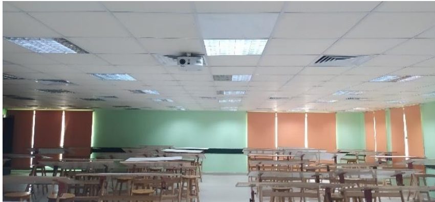
شكل (4) وحدات الإضاءة المستخدمة في المبنى (الباحث)
