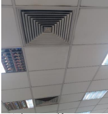
شكل (3) وحدات التكييف المدمجة في سقف جميع فراغات المبنى (الباحث)
