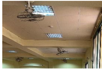
ب) المراوح المستخدمة في القاعات التدريسية في المبنى
